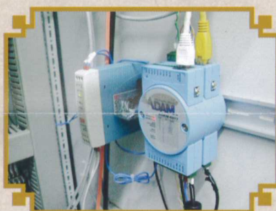
CEMS現場接收監測訊號模組架設
