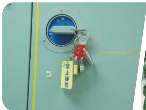
設備隔離掛牌
