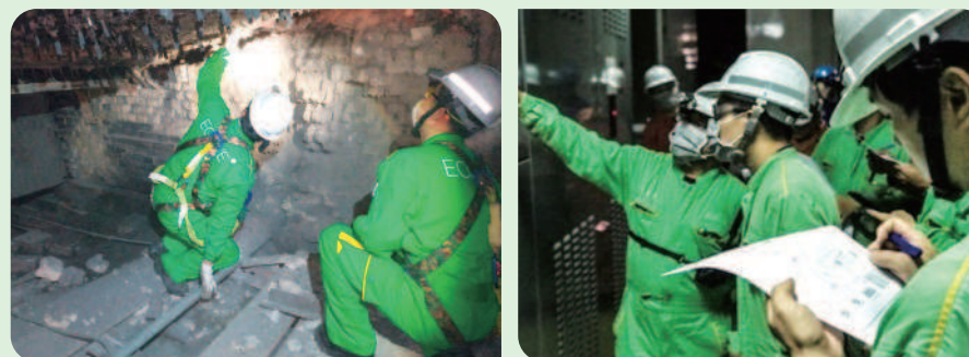
崑鼎專業團隊執行設備維護保養及檢修剪影 (左圖為爐內檢修，右圖為消防系統點檢)
