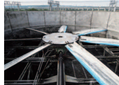
烏日廠原冷卻水塔風扇組
