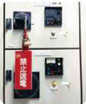
▲ 設備隔離掛牌
