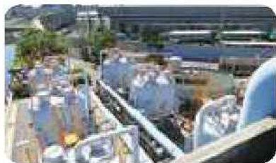
▲ 中港水資源回收中心
