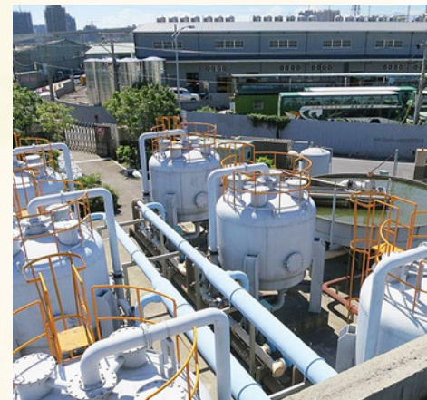
中港水資源回收中心
