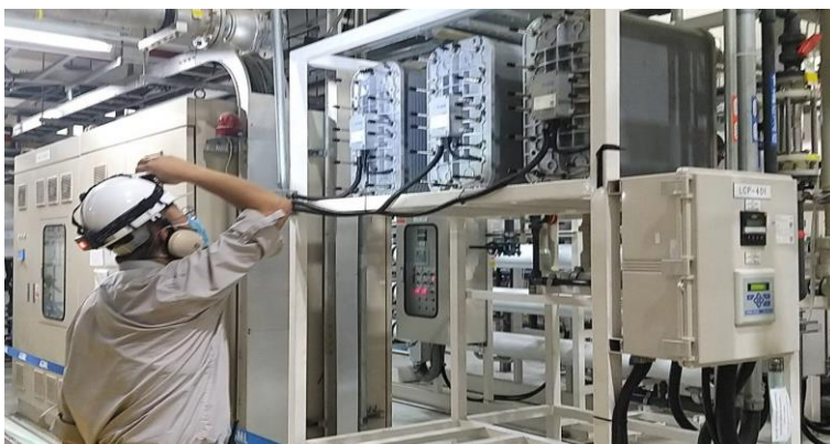
冰水主機房設備巡檢
