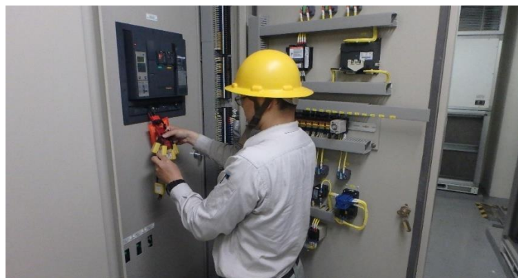
MCC設備保養斷電作業
