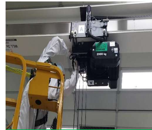
無塵室天車檢修
