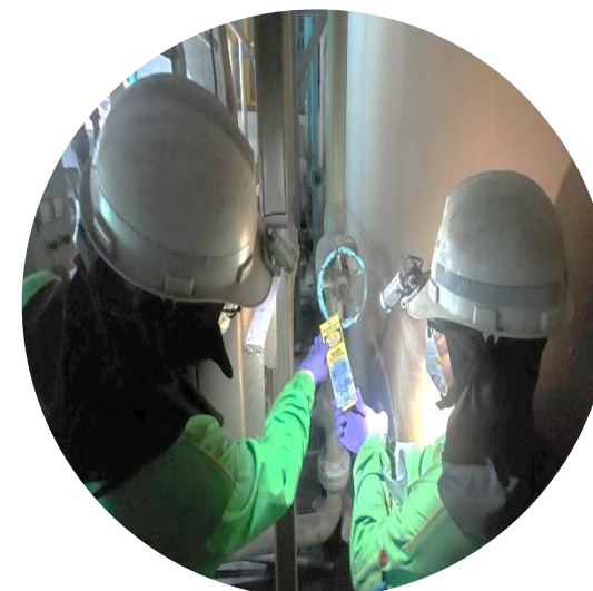
管線設備隔離暨掛牌警示 ECOPE A CTCL Company
