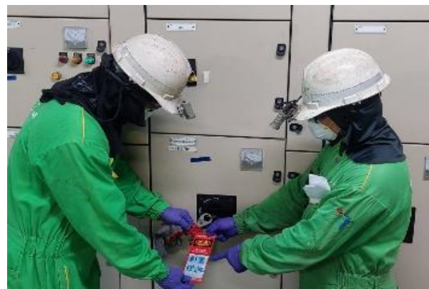
電氣設備隔離暨掛牌警示
