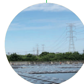
水面型 / 高鐵烏日滯洪池 / 0.3 MWp
