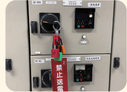
設備隔離掛牌
