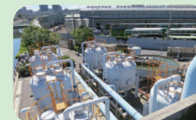
中港水資源回收中心
