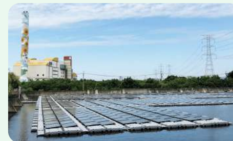
● 水面型 / 高鐵烏日滯洪池 / 0.3 MWp
