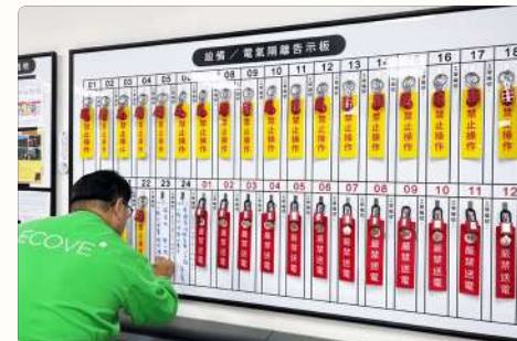
設備隔離挂牌
