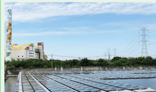
水面型 / 高鐵烏日滯洪池 /0.3 MWp
