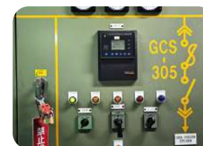
○ 設備隔離掛牌
